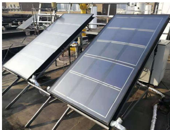
Fig. 4. Actual setup of two a-Si PV/T systems.
