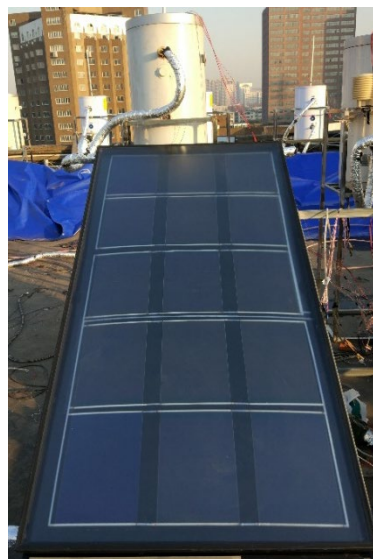
Fig. 1. Actual setup of the a-Si-PV/T system test rig.
